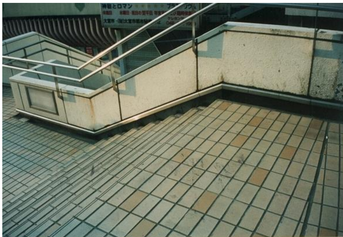
写真 2 弱視には段差がわかりづらい階段
